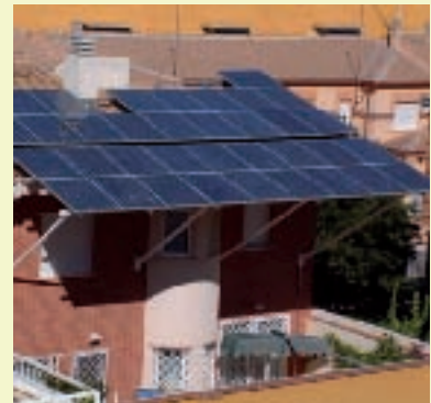
Instalación doméstica de energía solar fotovoltaica.
